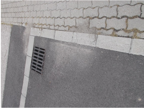
Aszfaltburkolat lejtése nem megfelelő
