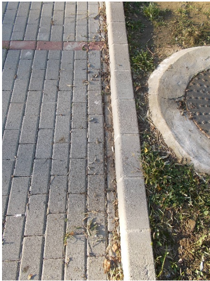
Térkő burkolat megsüllyedt
