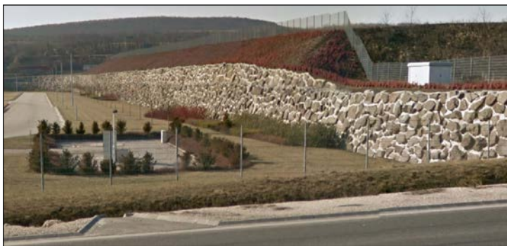
32. ábra: Az ALDI logisztikai bázisának északi csücskében található transzformátor állomás és gázfogadó
