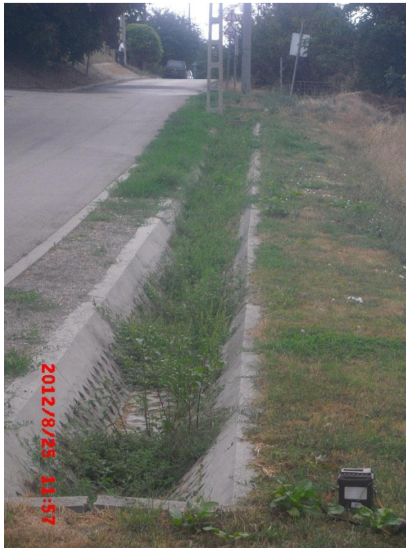
növényzettel benőtt betonozott nyitott csapadékelvezető árok – Jókai utca vége
