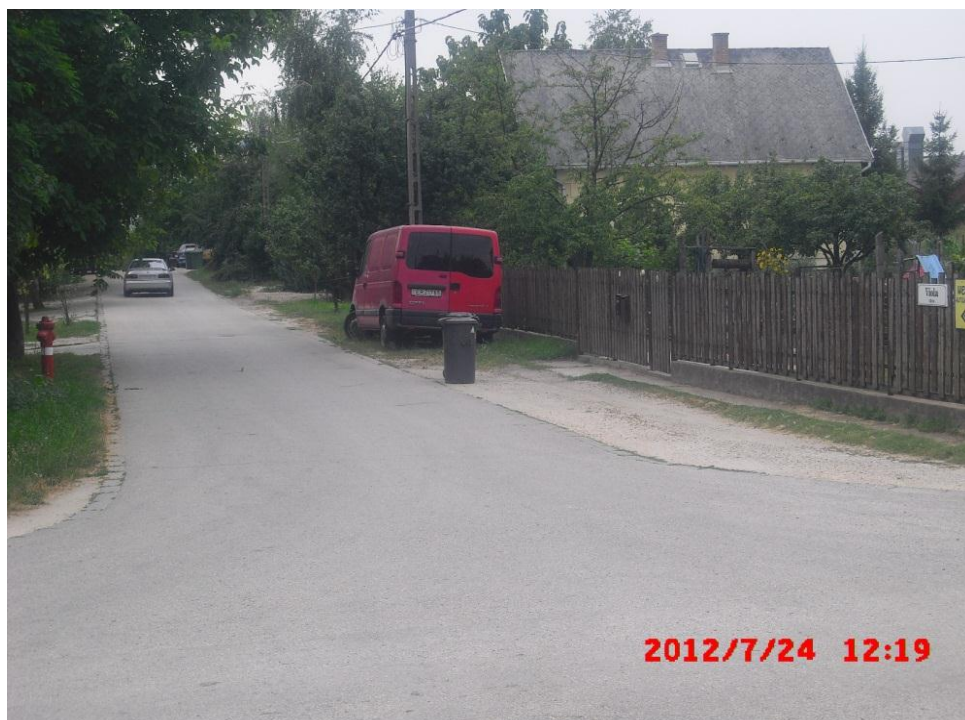
nincs csapadékelvezető árok – Viola utca
