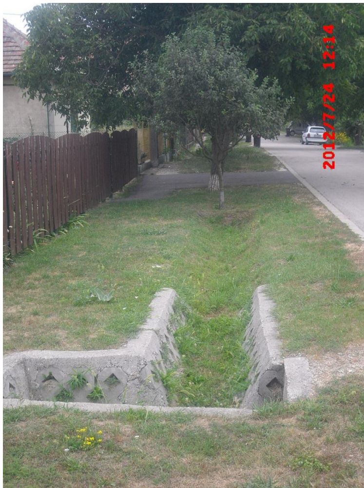
Biai Gáspár utca – nyílt betonozott elvezető árok, növényzettel benőtt
