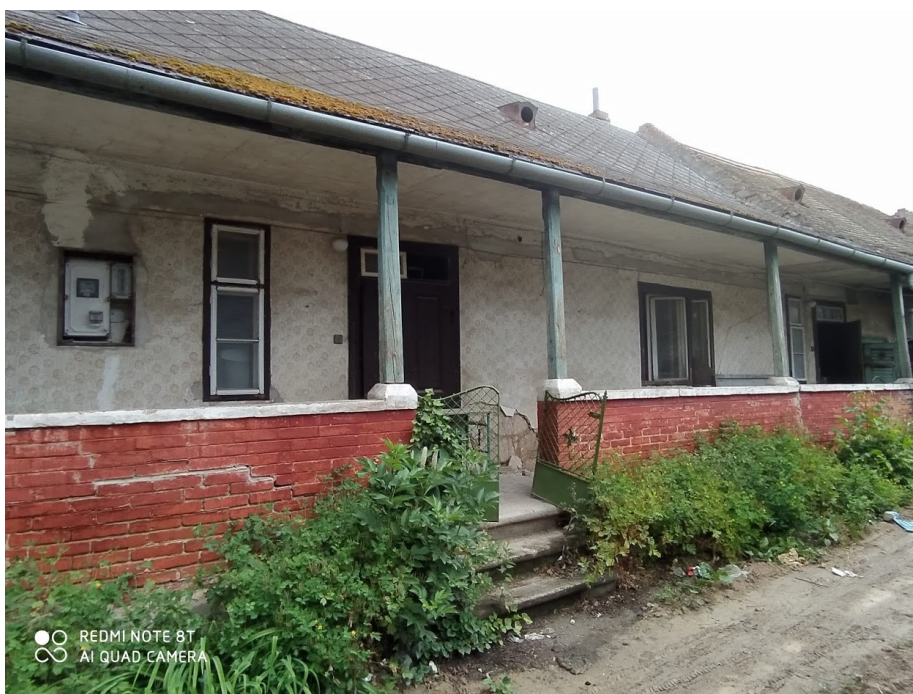
Az épület udvari homlokzata a megrepedezett mellvédfallal
