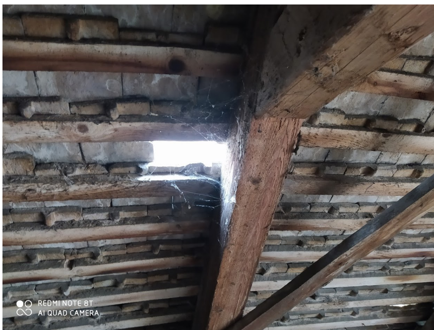
Korrodált hódfarkú cseréphéjazat
