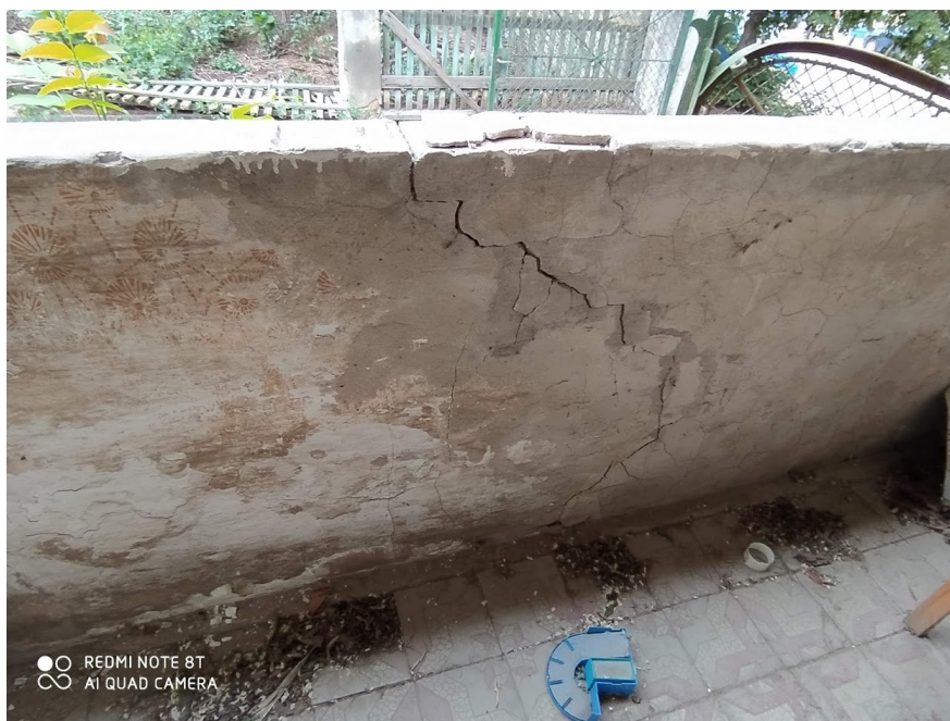
Átrepedt veranda mellvédfal
