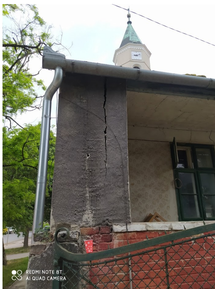
Megnyílt falpillér az utcai homlokzati falon
