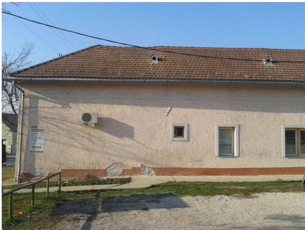
Külső homlokzat a deformált tetőrészsel, illetve a szélső fal repedéssel
