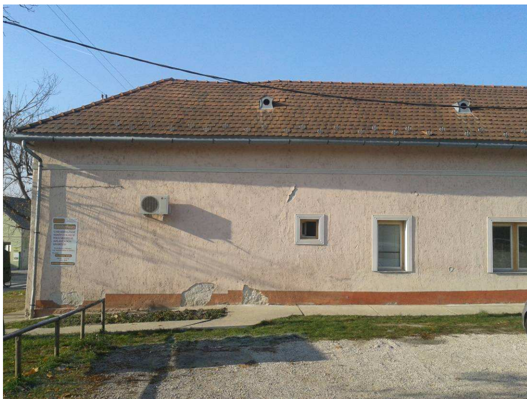
Külső homlokzat a deformált tetőrészszel, illetve a szélső fal repedéssel
