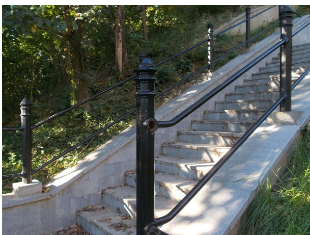
A korlát hegesztése nem megfelelő, korlátelem hiányzik
