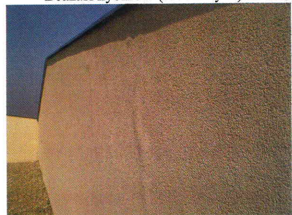
Rossz hőszigetelés (több helyen)
