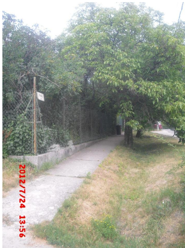
növényzettel teljesen benőtt nyílt csapadékelvezető árok – Petőfi utca
