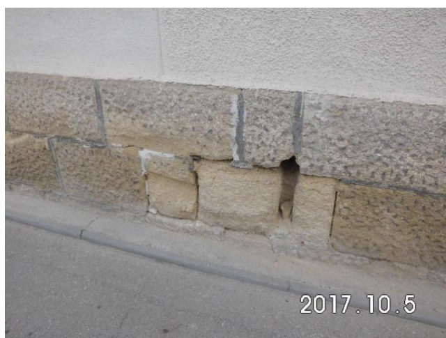
A lábazati építőkövek mállanak.
