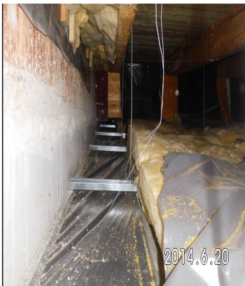
Hiányos hőszigetelés párasodást és hőhidakat okoz.
