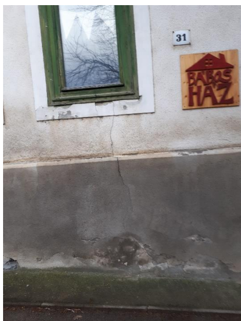
Az utcai homlokzaton nedvesedés látható.
