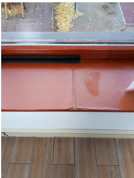
Az ablakoknál is beázik az épület.
