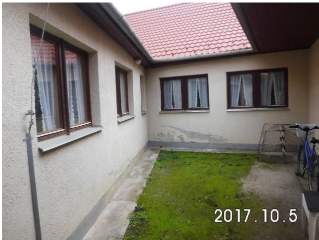
A vaklat vizes, hullik. A nem megfelelő csapadékvíz elvezetés is áztatja a falakat
