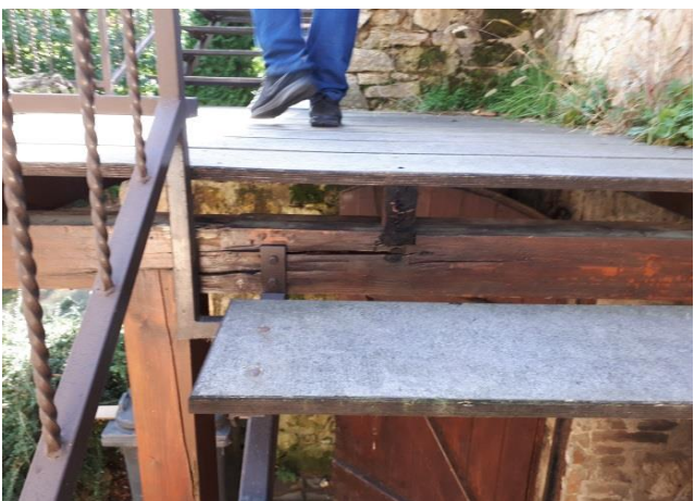
A lépcső acél tartószerkezete az elkorhadt faszerkezethez csatlakozik.
