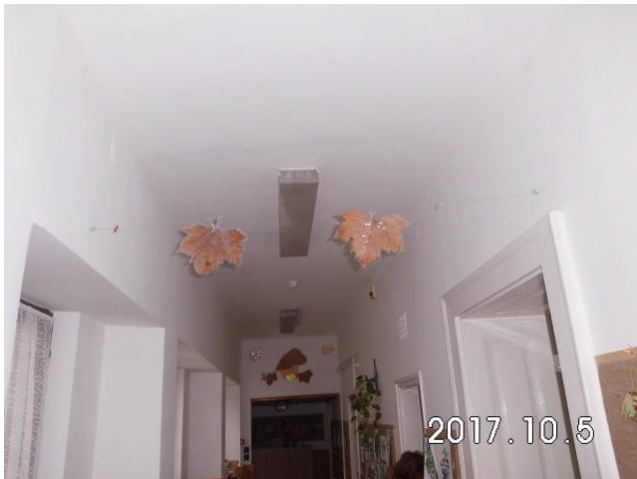
A világító testek és szerelvények elavultak
