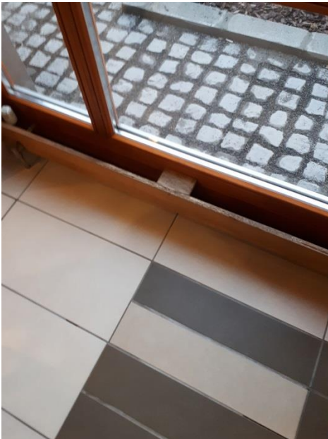
A belső fafelületek rendszeres kezelését meg kell oldani, mert visszafordíthatatlan károsodás lehet.
