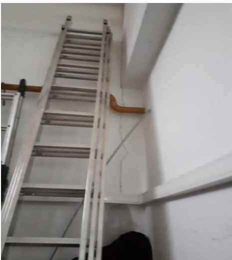
A falazat repedései a földszinten.
