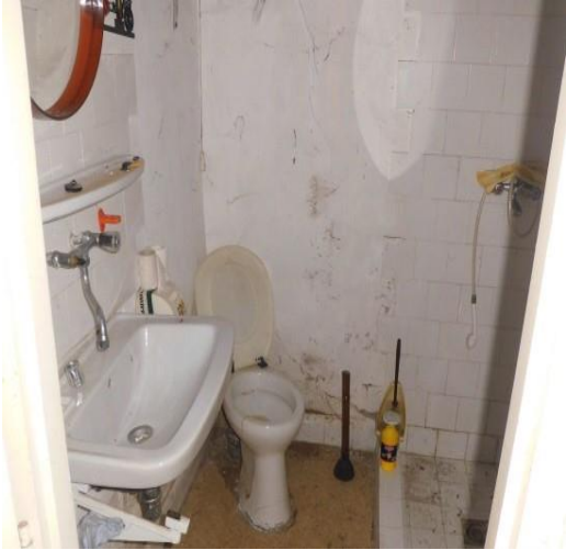
A vizesedés az épületen belül is látható.
