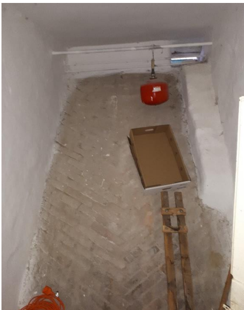
Fűtetlen térbe átmenő szigetetlen fűtéseső ami fagyveszélyes.
