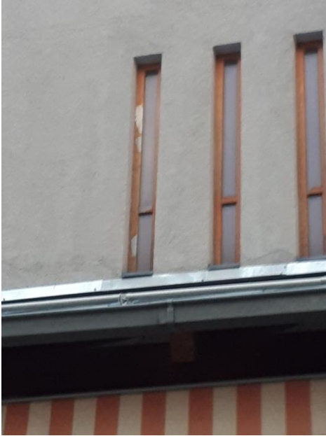
A nyílászárók felülete romlik.
