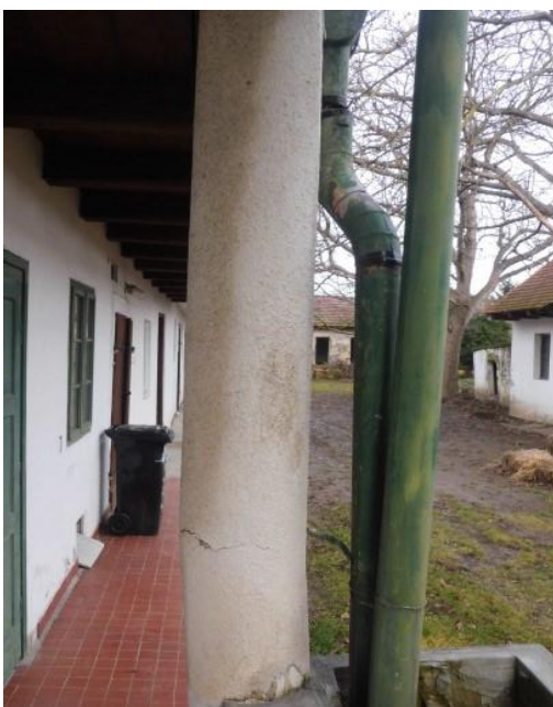
Az eltört oszlop, tőle jobbra a vízgyűjtő betonkád.
