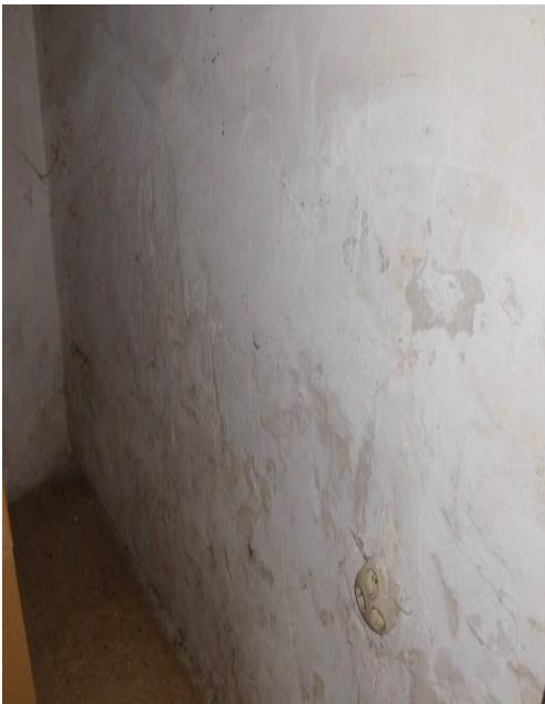
Az épület szomszéd felőli oldalán az esőcsatorna hiánya miatt a tetőről lefolyt víz áztatja a főfalat.
