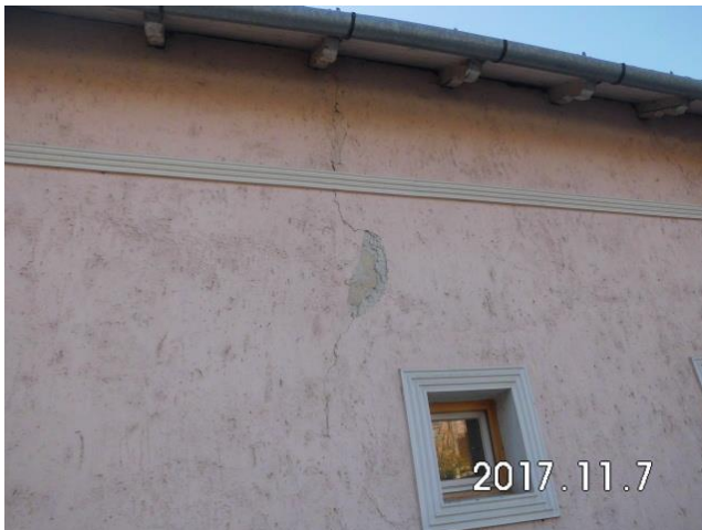
Az épület falazatán szerkezeti repedések találhatóak.
