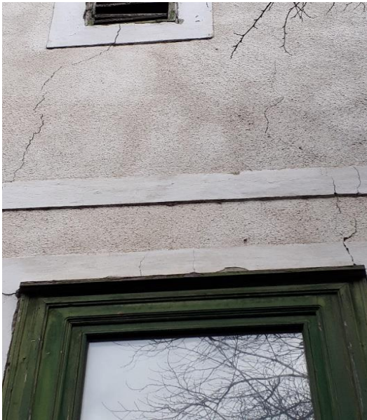
Megjelentek a szerkezeti repedések a nyílászárók sarkinál.
