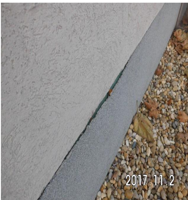
A lábazat az épület körül körben elvált.
