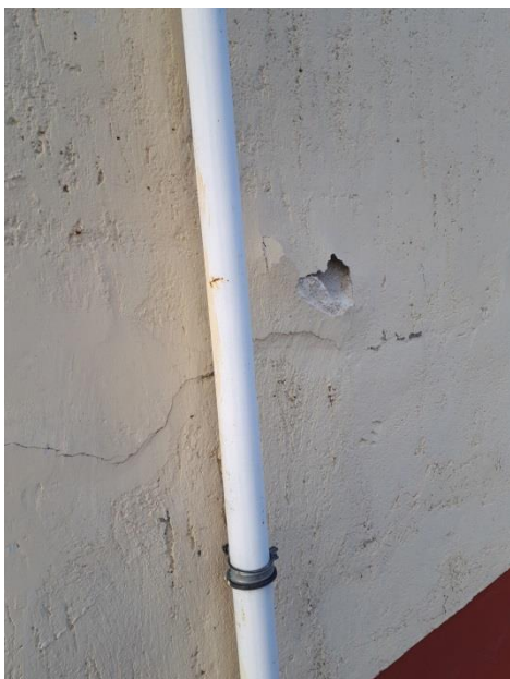
A homlokzaton repedések vannak.
