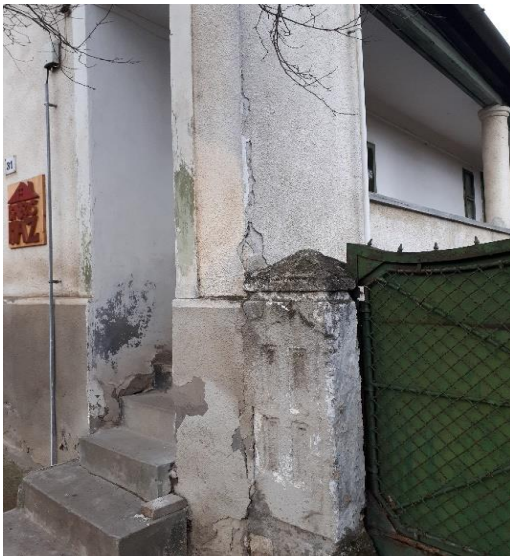
Tornác utcai pillérénél a nem megfelelően elvezetett esővíz miatt megsüllyedt.
