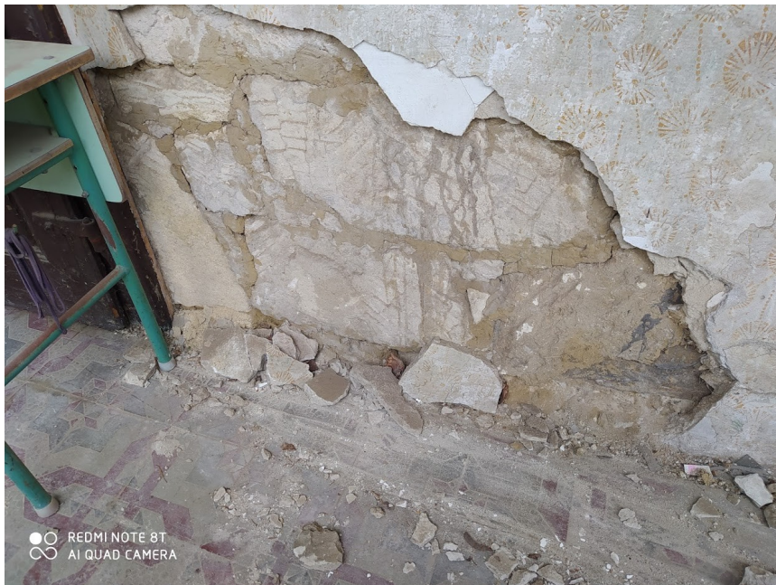
Nedvesedés miatt levált vakolat, láthatóvá vált az agyagba rakott szabálytalan alakú mészkövekből rakott fal
