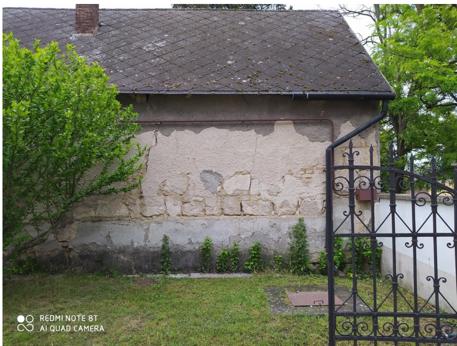
Több repedés a falon
