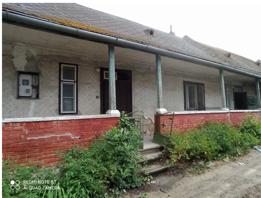
Az épület udvari homlokzata a megrepedezett mellvédfallal
