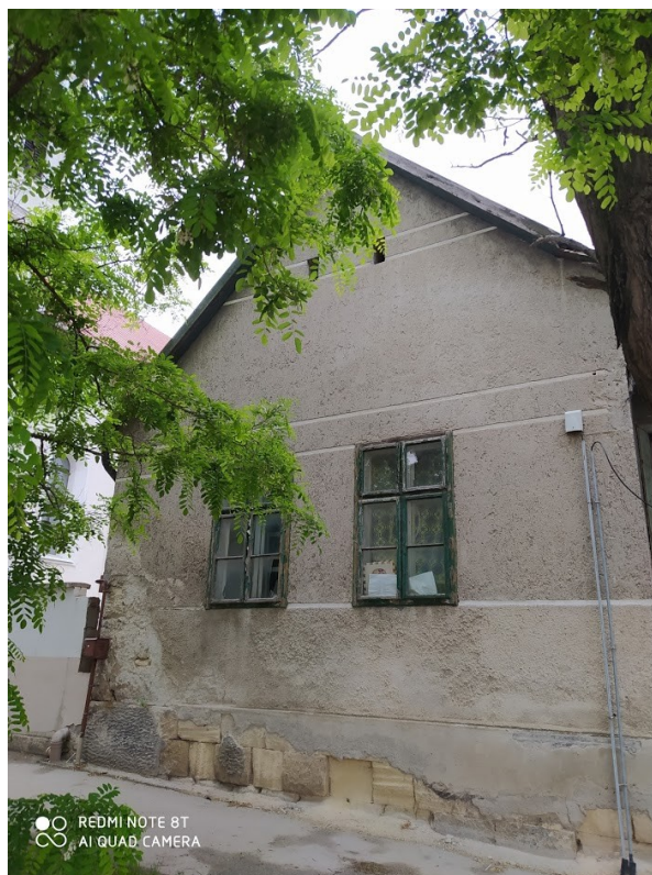
Az épület utcai homlokzata az erősen korrodált lábazati mészkővel
