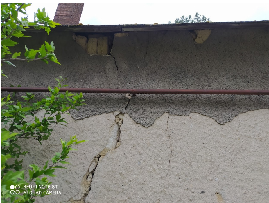
Jelentős mértékű repedés a hátsó homlokzati főfalon
