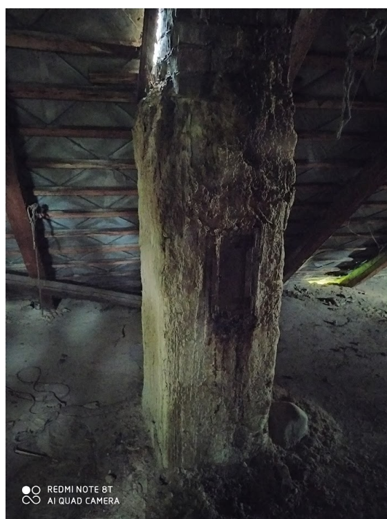
Erősen korrodált, lepusztult kémény
