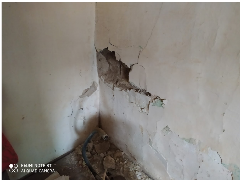
Igen jelentős, nedvesedés miatt létrejött falkorrózió
