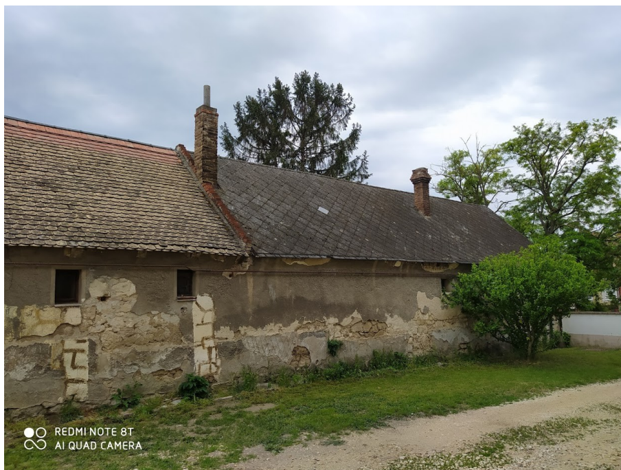
Az épület hátsó homlokzata, jelentős mértékű falnedvedéssel, korrodált kéményekkel
