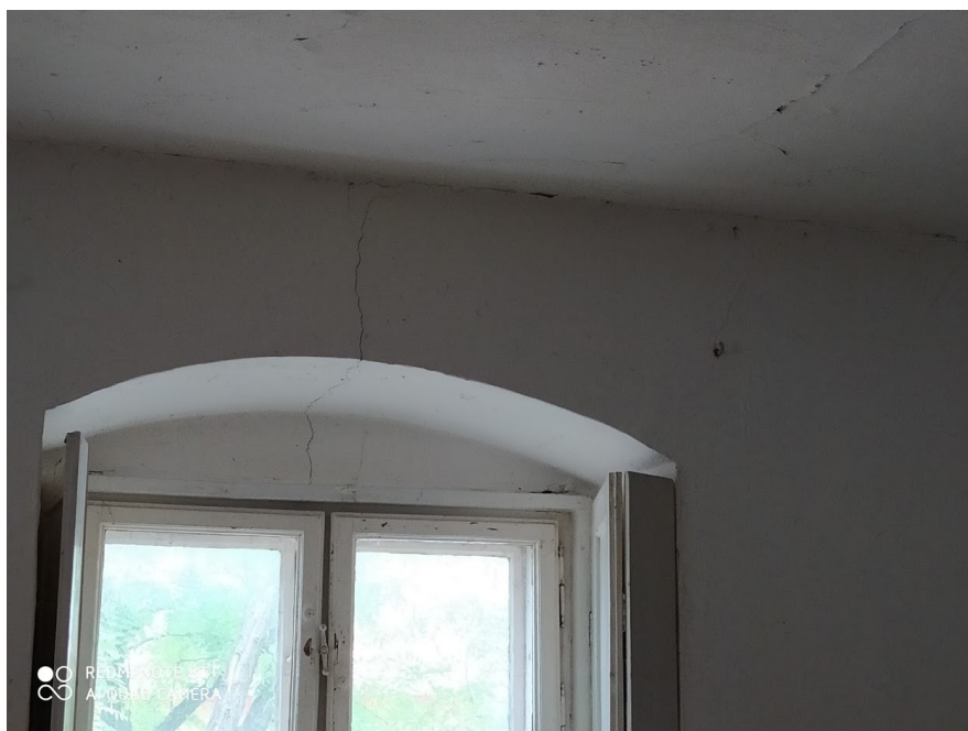
Az átrepedt boltozat, látható a repedezett mennyezet
