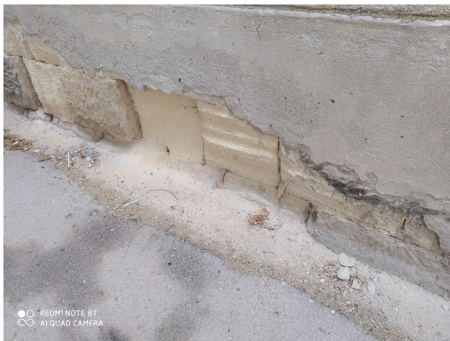
Korrodált lábazati sóskúti kövek az utcai homlokzaton
