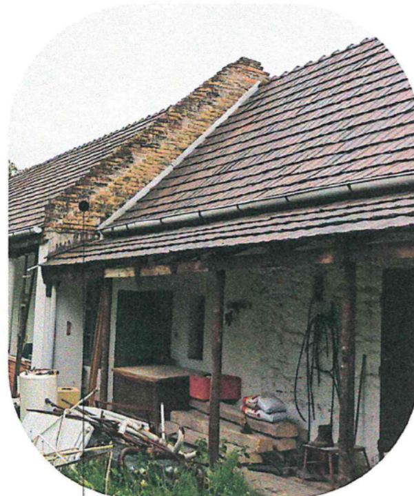
ÉPÜLETRÉSZEK CSATLAKOZÁSÁNÁL A VÍZELVEZETÉS ELEMEI CSERÉRE SZORULNAK, MELY JELEN PILLANATBAN FOLYAMATOSAN ROMLÓ ÁLLAPOTBAN VAN
