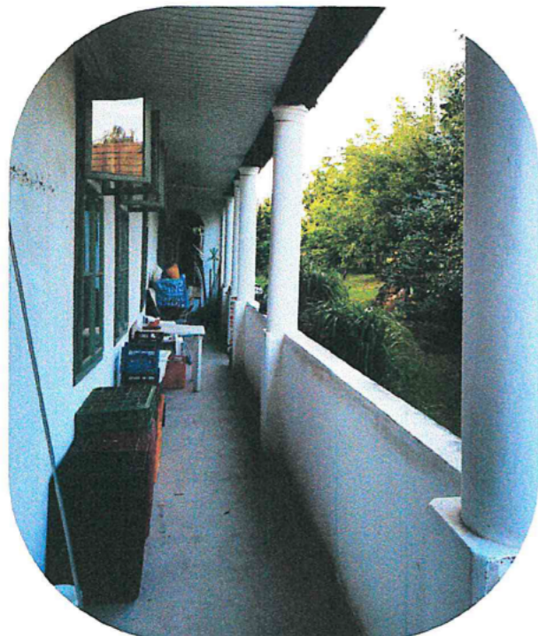
AZ ÉPÜLET EGYIK FONTOS JELLEGZETESSÉGE A TORNÁC. ENNEK A MEGŐRZÉSE MIATT A VÍZELVEZETÉS JAVÍTÁSA MINDENKÉPP SZÜKSÉGES, JELEN PILLANATBAN AZ ESŐVÍZ A HOMLOKZATI FALAKAT KÁROSÍJTJA
